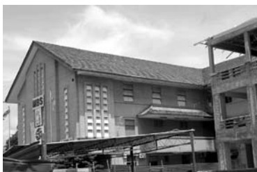
BANGUNAN lama (kiri) dan bangunan baru MBS yang masih di dalam proses pembinaan.
