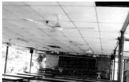
维修前，食堂天花板破烂不堪。
