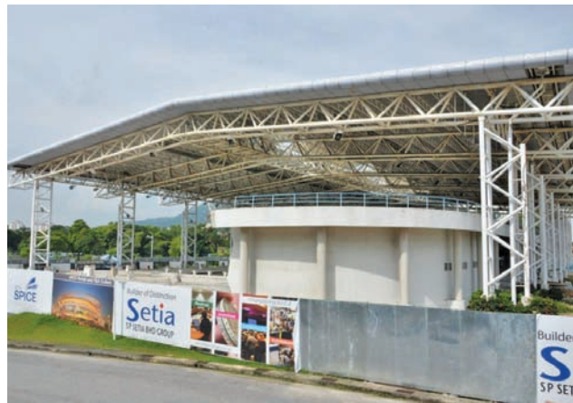
槟州地下国际会展中心的施工工程则将在2013年3月开工，预料2016年9月才能完成。
