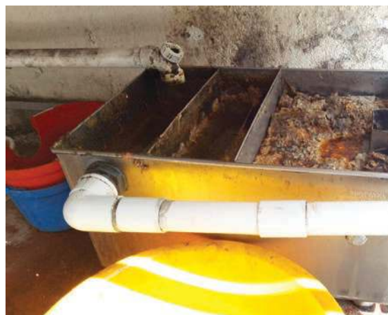
TIDAK memasang perangkat minyak antara kesalahan yang dikenal pasti.
