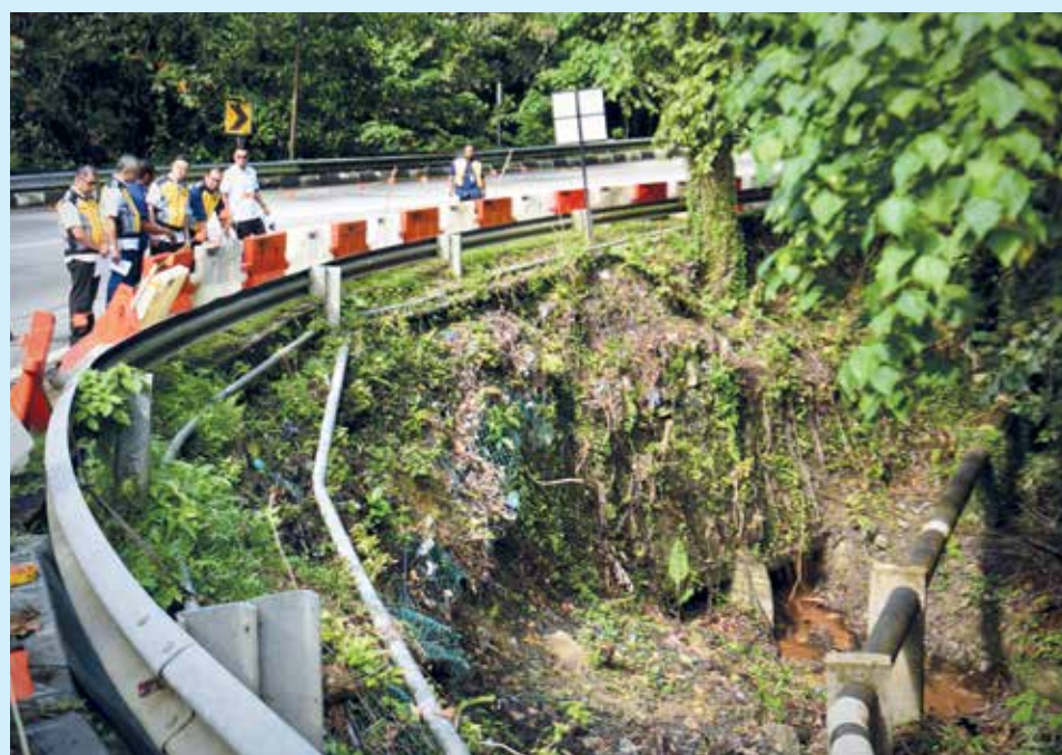
ZAIRIL Khir Johari (empat dari kiri) meninjau salah satu kawasan cerun yang akan dibaiki di Jalan Batu Feringghi di sini baru-baru ini.
